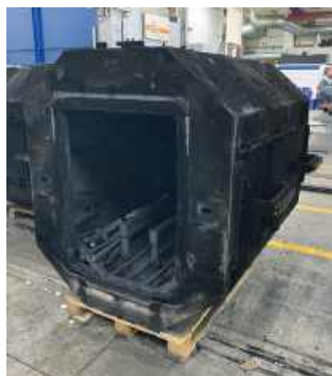
Печь до замены нагревательной камеры
