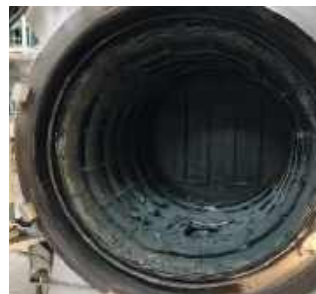
Печь до замены нагревательной камеры
